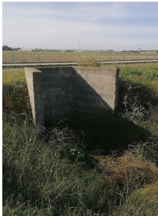
Fotografia 2 – Vista da PH de entrada
